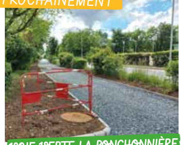
VOIE VERTE LA PONCHONNIÈRE qui dessert les entreprises locales et le Lycée Germaine Tillon
