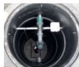
Ex. de poste de relevage
