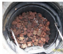
Ex. de préfiltre à pouzzolane
