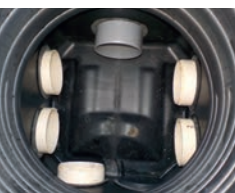
Ex. regard de répartition
